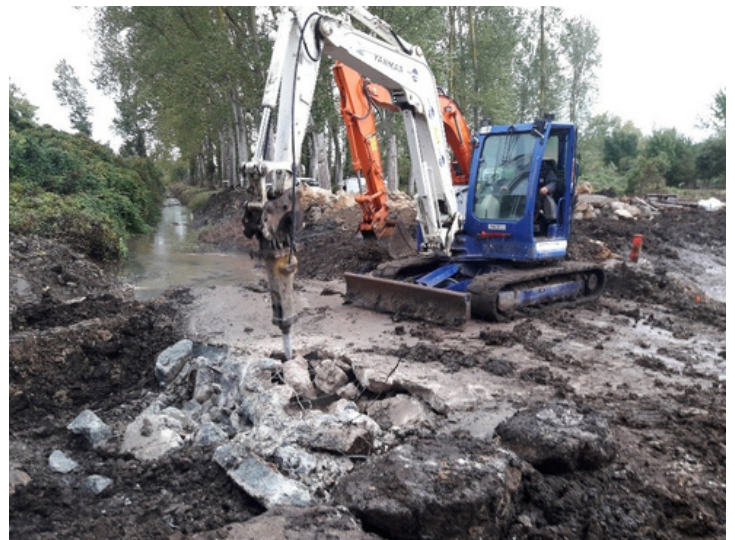
Destruction du pont-canal - Crédit image F. Bergé - SBNM
