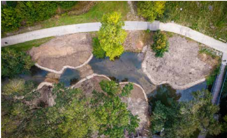
Resserrement du lit du Petit Cher et création des radiers (Happy Pixel)
