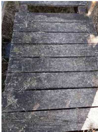
Le plancher de la passerelle avant réparation : une latte arrachée
